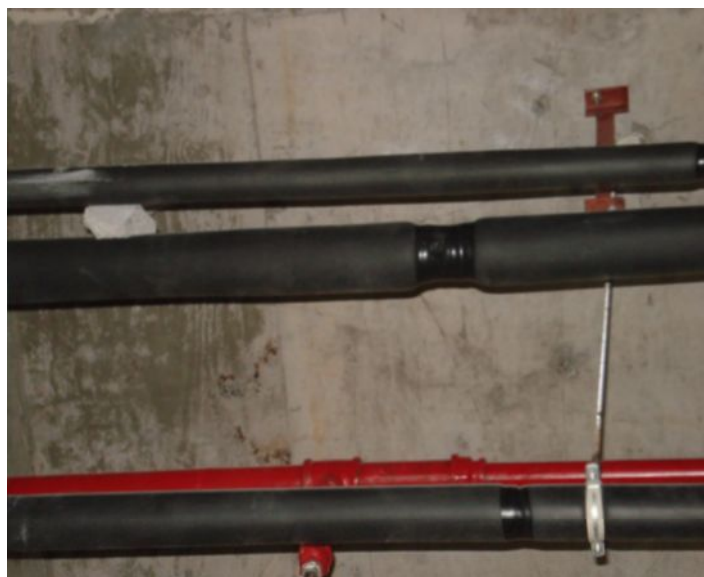
Стыки имеют тонкую теплоизоляцию
